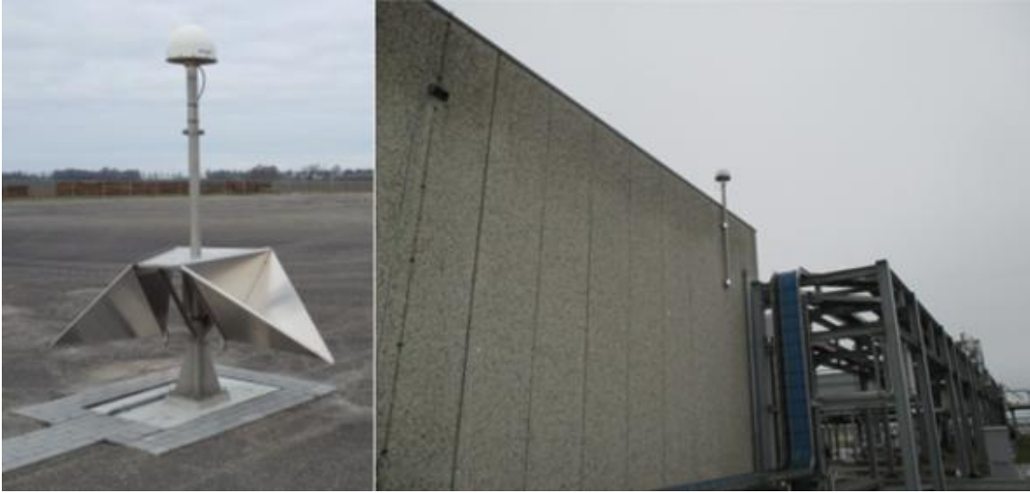
Figuur 3-1: IGRS-station (links) en GNSS-station (rechts) bevestigd op een gebouw op een NAM-locatie.
